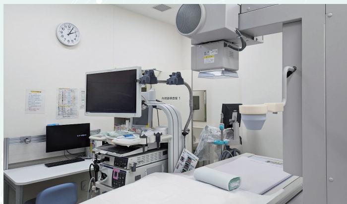
内視鏡検査室内に設置されたNTPクロック
