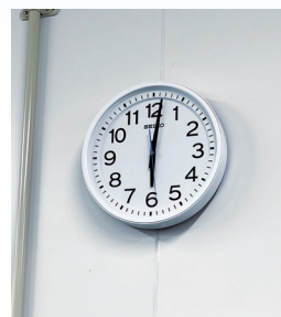
工場内に設置されているNTPクロック
