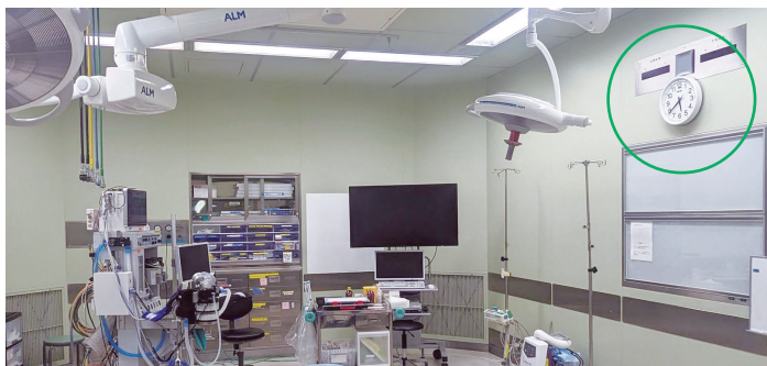
手術室に設置されたNTPクロック
